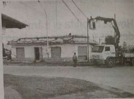
El edificio que se derrumbó en General San Martín, donde un hombre murió al quedar bajo los escombros.
